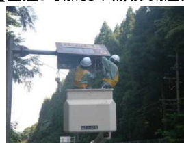
【国道8号加賀市熊坂 気温計】
