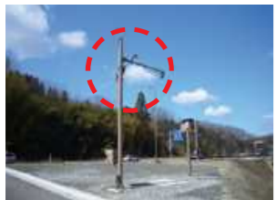
道路テレメーター (気温・雨量・積雪量・風向など)
