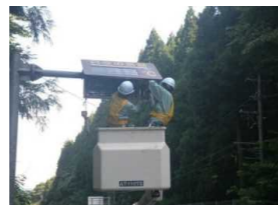
【国道8号加賀市熊坂 気温計】
