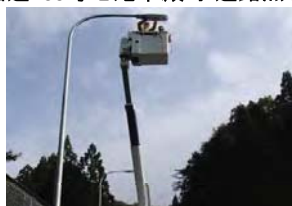
【国道160号七尾市殿町 道路照明灯】
