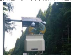
【国道8号加賀市熊坂 気温計】
