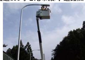
【国道160号七尾市殿町 道路照明灯】
