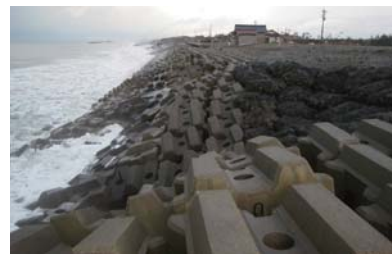
小松市安宅新町地内の被災状況(平成23年1月)
