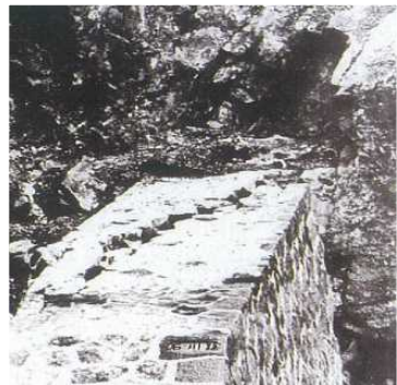
図2-2 甚之助谷第5号堰堤の亀裂(昭和3年)
