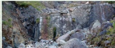
白山砂防で最も高所に造られた練石積堰堤。大正時代の練石積堰堤として唯一竣工時のまま手を加えられていない。
