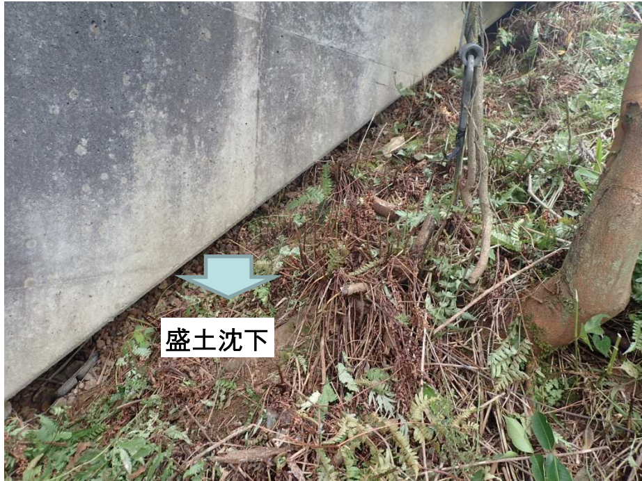
【ウイング下面の盛土沈下】
