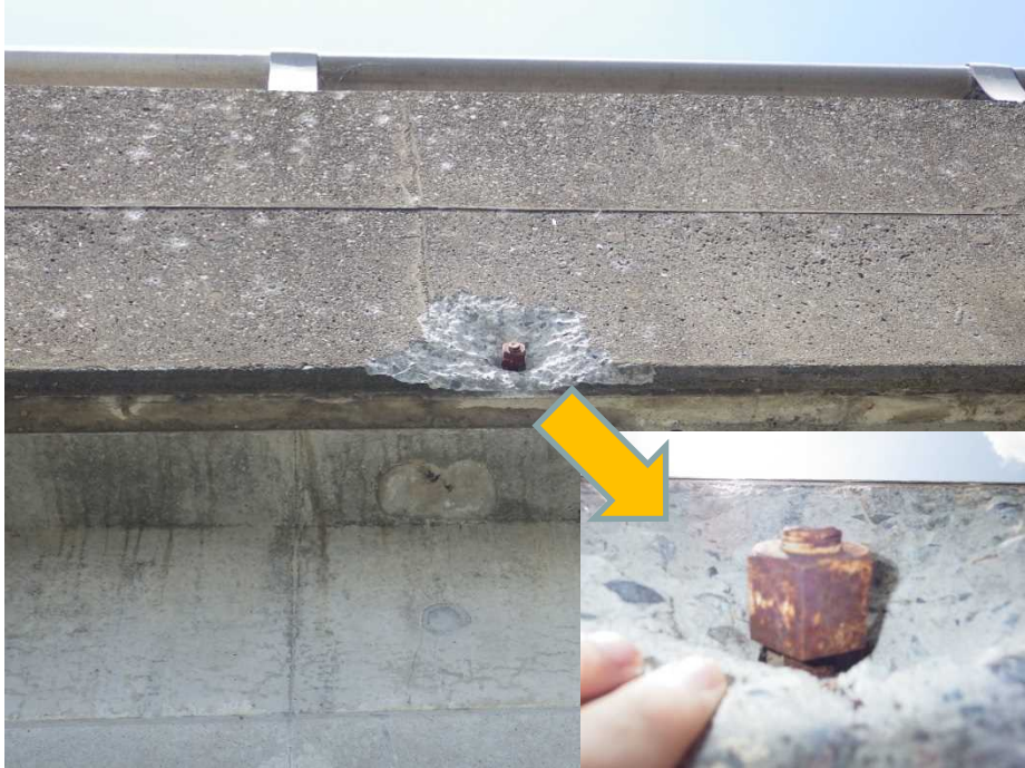
【PC床版横締め鋼棒の破断】
