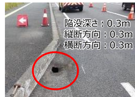
残置された管が起因した陥没事例 国道5号（北海道札幌市）
