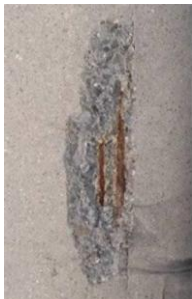
コンクリートの剥離・内部鉄筋の錆
