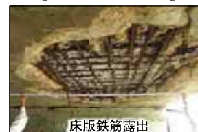
床版鉄筋露出
