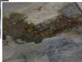
覆工コンクリートの剥落・貫通ひびわれ
