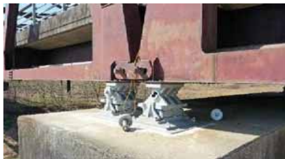
P3支承（可動）：ピンの脱落
