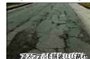
アスファルト舗装ひび割れ
