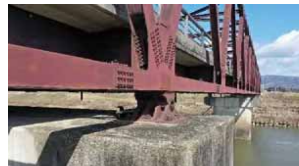
P2支承（固定）：ピンの脱落
