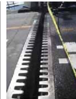
A1橋台上の伸縮装置の開き 〔橋軸方向：約40cm 橋軸直角方向：約20cm〕
