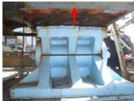
P2支承（固定）： 下弦材と上沓の間の溶接が外れ上部構造が移動
