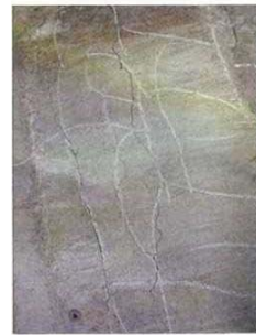
下部工のひび割れ
