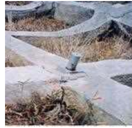
写真 受圧構造物の破損の例
