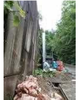
写真 壁面の傾斜の例
