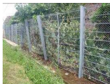
写真 落石防護柵の傾動の例
