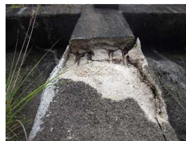
法枠工の老朽化損傷
