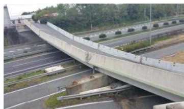
ロッキング橋脚を有する橋の落橋
