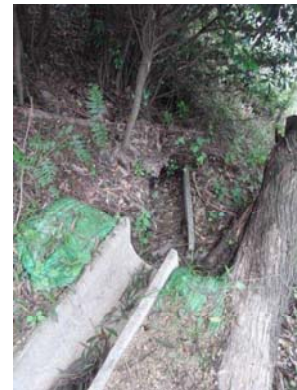
写真 排水溝の破損の例
