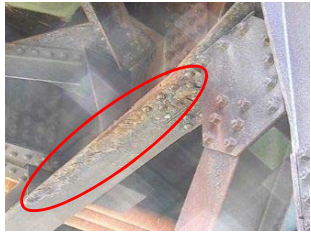
耐候性鋼材に層状の剥離
