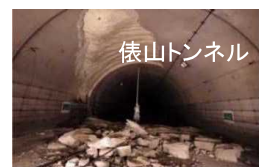
覆工コンクリートの崩落
