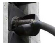
ケーブル損傷例
