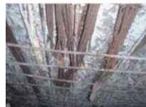
PC鋼材の腐食例
