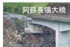
斜面変状による橋台の沈下
