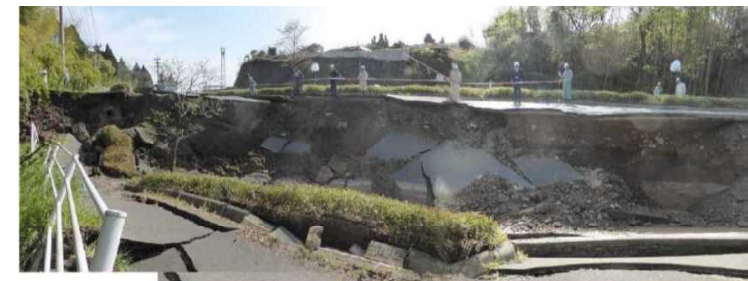
路面陥没地付近の状況（4月15日）
