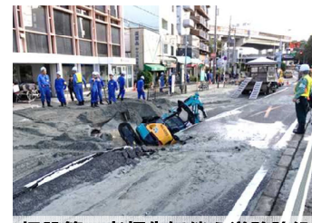
埋設管の老朽化に伴う道路陥没
