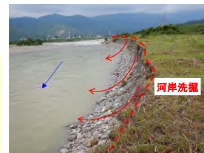
令和4年8月洪水時の河岸 洗掘状況 (左岸12.2k付近)
