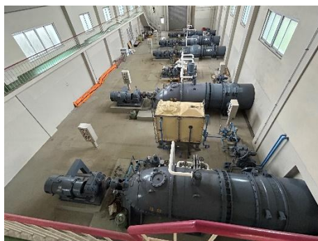
今江潟排水機場のポンプ
