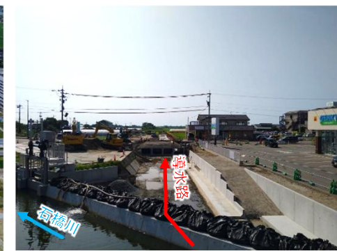
分水施設（越流堰）
