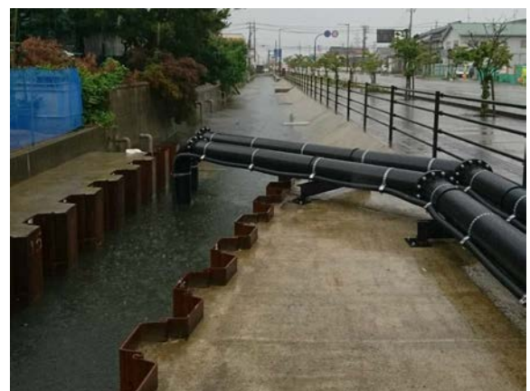
排水ポンプの自動運転化
