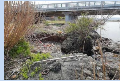
左岸側高水敷の洗掘
