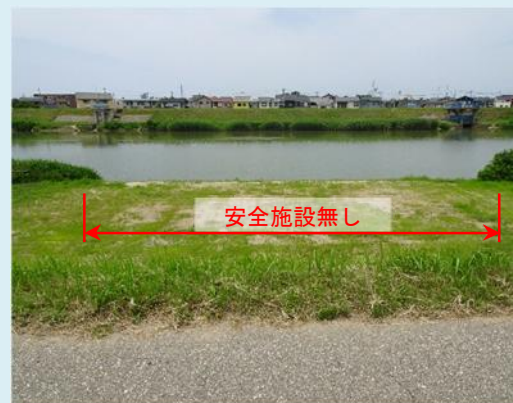
水際は矢板護岸だが 安全施設や植生がなく 転落のおそれがある
