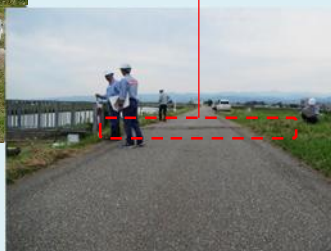
堤防天端 の段差
