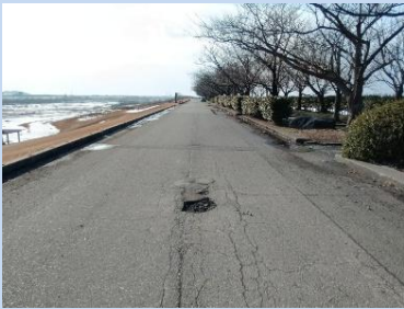
堤防天端中央のポットホール
