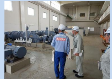
今江3号揚水機場
