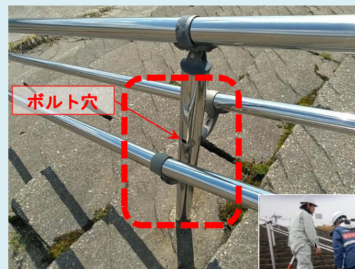
階段護岸の 手すり脱落
