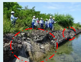
かごマットの破損 2箇所を確認
