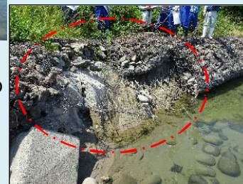
かごマットの 破損状況
