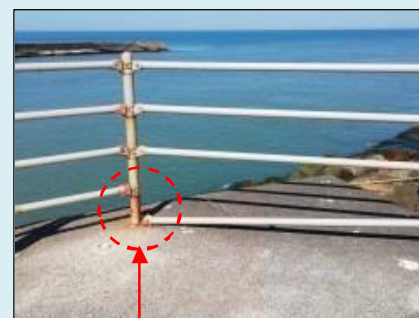
防護柵のパイプが1本脱落
