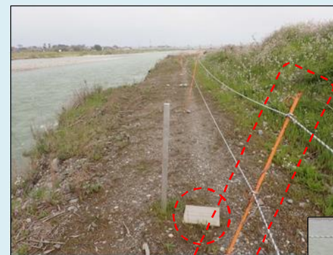
立入禁止措置の ロープ柵が倒れかけ 注意喚起看板が脱落
