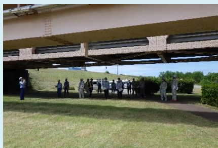
L4.0kp付近 桁下余裕高不足箇所
