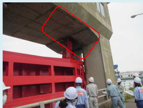
右岸-0.15kp-18m 門柱上部のクラック・剥離を確認
