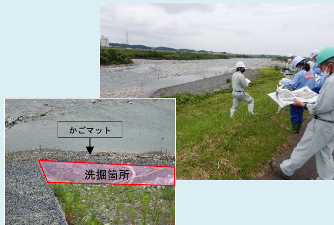
右岸9.0kp-40m かごマット背面の洗掘を確認
