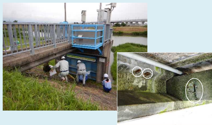
右岸3.8kp+32m 島田町樋管 コンクリート剥離・鉄筋露出を確認
