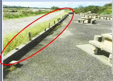
木柵が著しく劣化している
