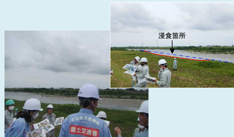
左岸12.2kp+50m～12.6kp+100mの河岸浸食を確認
