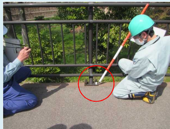
堤防天端に設置した防護柵で、支柱を固定するボルトのキャップが損失
