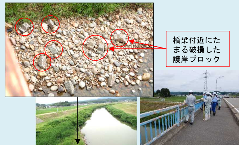
右岸9.4kp～9.4kp+100m 護岸ブロック流失を確認
