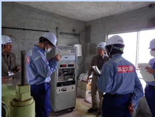
美川水門(外)水位観測所
