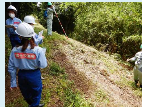
右岸12.0k～12.4k 表法面にイノシシによる損傷
