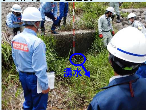
左岸13.2k+15m 低水護岸基礎下面水抜き穴より大量の湧水を確認
