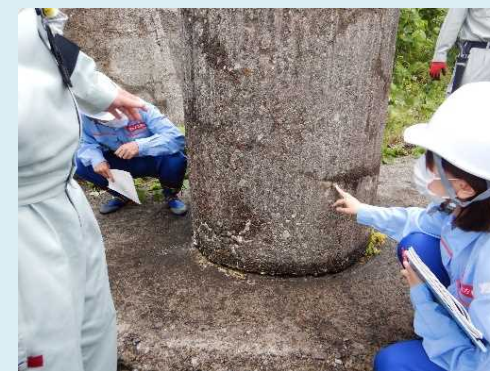
右岸10.8k ポスト水制にクラック及び基礎間隙間を確認
