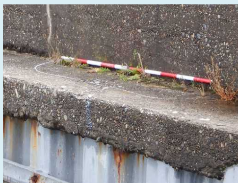
右岸-0.15k+30m 笠コンクリート前面の破損、鉄筋露出(L=19.3m)
