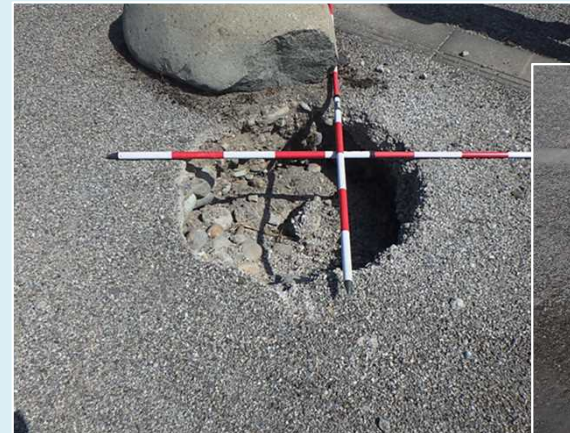
陥没穴の状況（φ1.0m・深さ0.6m）
