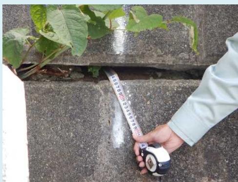
左岸9.8k+130m 鴨浦橋下流側取付護岸目地部に開き(長さ3.5m、幅4.0cm、深さ35.0cm)
