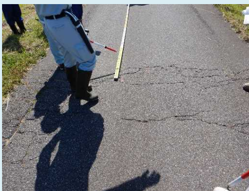
左岸1.4k+170m 鶴ヶ島終末処理場放流樋管に天端舗装クラックあり
