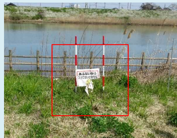
注意喚起看板破損
