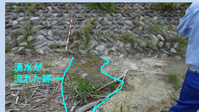
右岸14.2km付近 低水護岸からの湧水 石積護岸からの湧水が複数箇所ある
