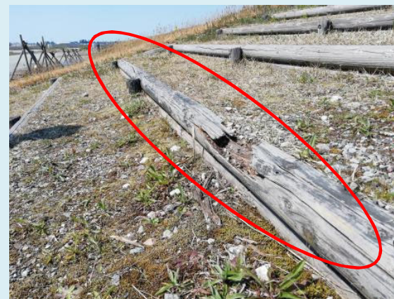
木製階段の腐食状況
