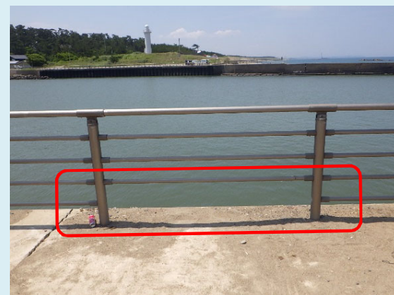
パイプ柵損傷(脱落)状況
