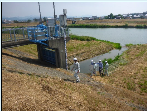
梯川右岸3.8km付近 越水(溢水)B
