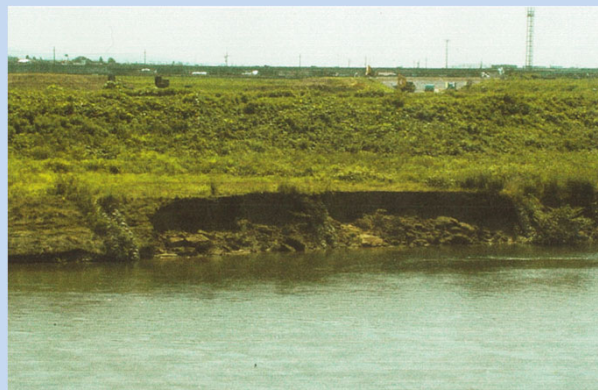
R2.7(梯川) 左岸側9.9k付近で堤体洗掘
