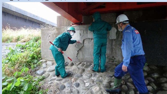
左岸9.8km+70m付近 川北大橋左岸側 橋台前面のコンクリートが剥離
