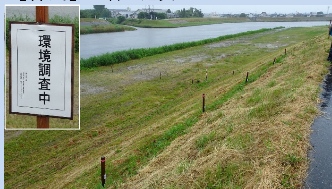
左岸4.4km+100m付近 小動物の穴対策 対策について、調査継続中
