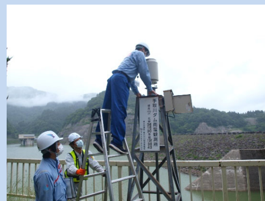
手取川ダム雨量計点検状況
