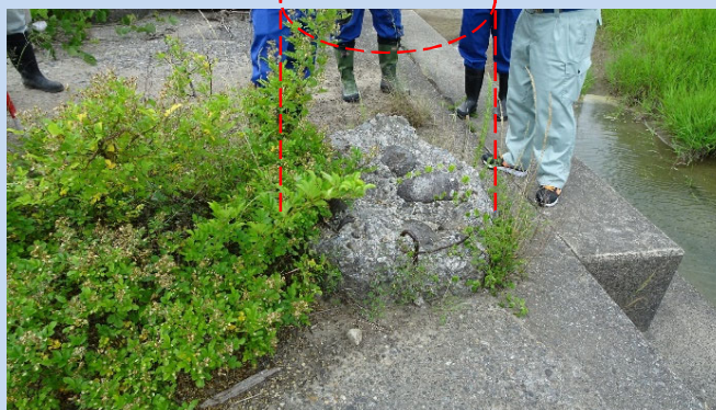
右岸9.0km付近 水制工損傷 ポスト1本が根元から折れている
