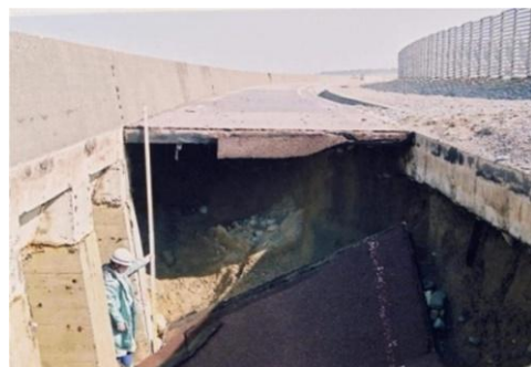
天端陥没 (平成14年1月 片山津工区)
