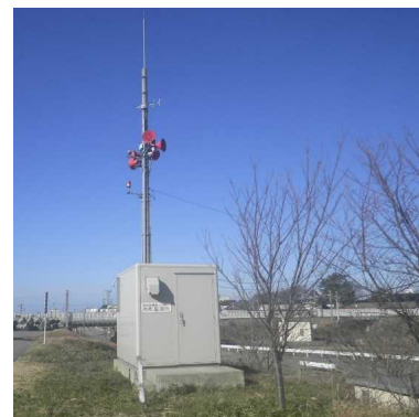
放流警報設備のサイレンの増設等
