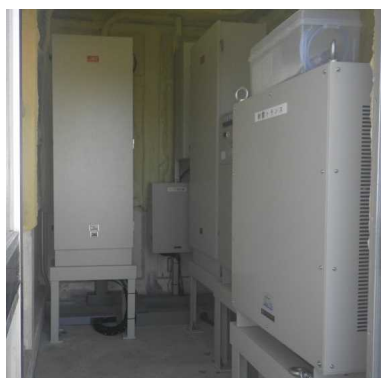
放流警報設備の耐水化(機器嵩上げ)
