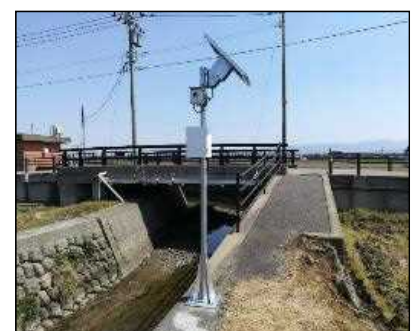
簡易型河川監視カメラ設置写真(平瀬川)
