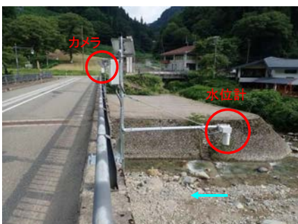
設置状況(直海谷川)
