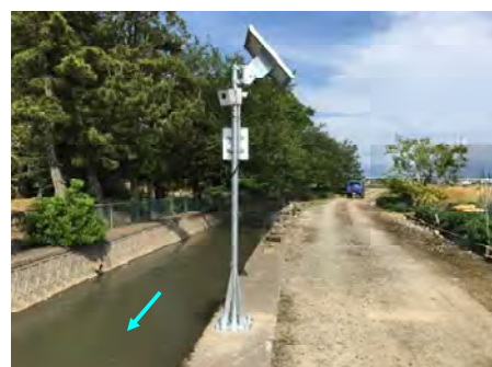
簡易型河川監視カメラ設置写真(堂尻川)
