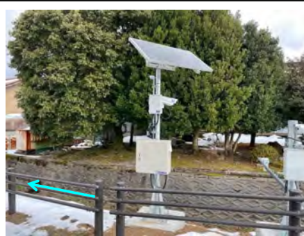
簡易型河川監視カメラ設置写真(粟津川)
