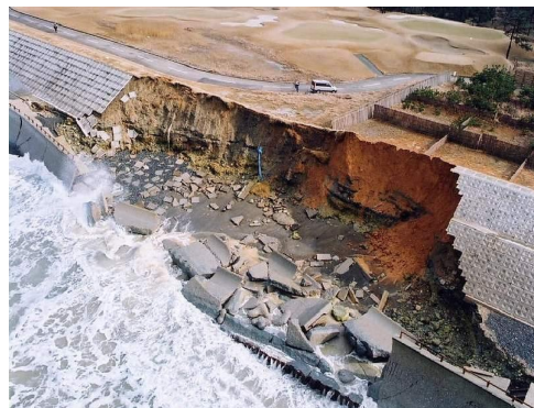
写真1-3 堤防決壊状況(平成12年1月小松工区)
