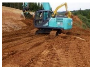
写真3-6 脆弱土上でキャタピラが埋まる建設機械
