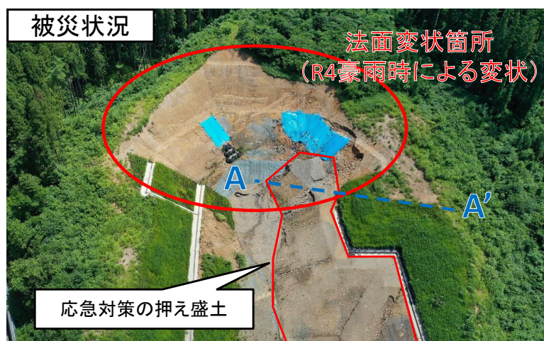
図3-4 大雨による被災状況写真 (R4. 8. 5)
