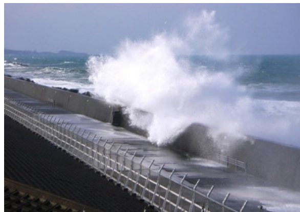
護岸の越波状況 ②
