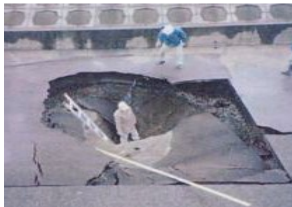
護岸背後の陥没状況
