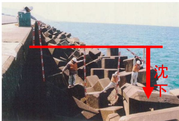
消波ブロックの飛散・沈下状況
