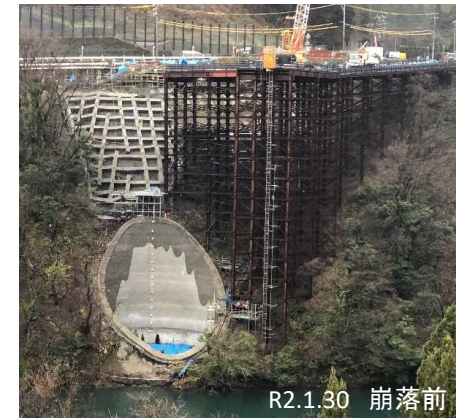
写真3-1 崩落前の状況
