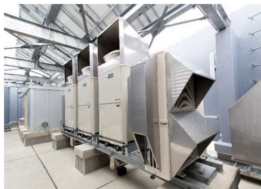
(浸水対応の為、屋上に設置した機器)
