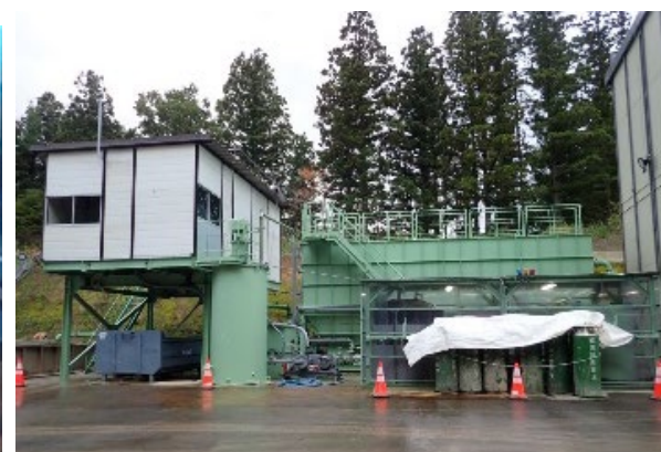
写真3 規模変更後の濁水プラント
