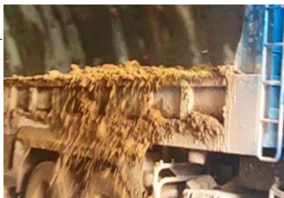
写真2 泥濘化の状況
