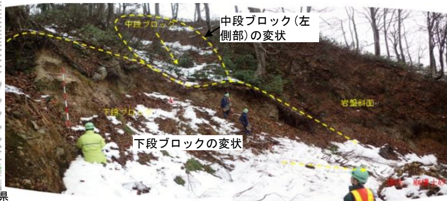
写真3 斜面変状の状況
