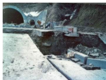
写真4-2 地すべり災害 (関川村片貝)
