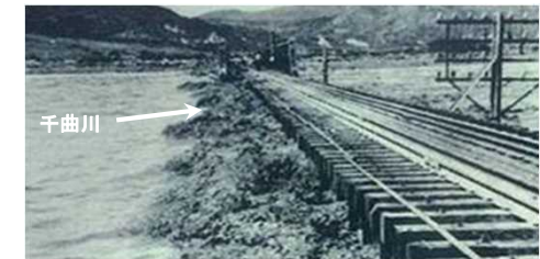
信越線篠ノ井鉄橋での出水状況
