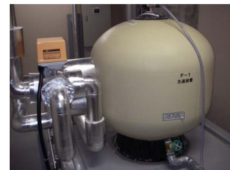
(雨水利用設備)
