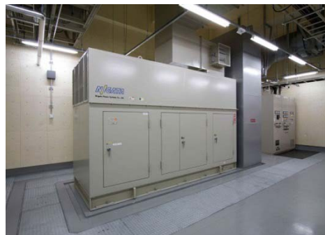
(災害対応の自家発電設備)
