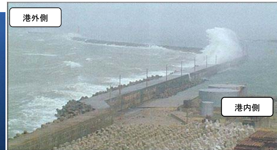
冬期波浪により港内・港外の状況
