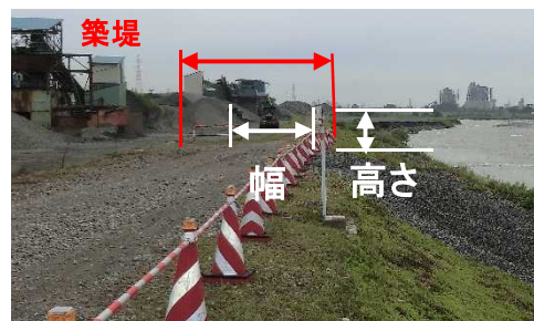
堤防断面不足の現状
