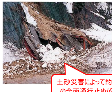
写真②: 土砂崩落による通行止め (富山市猪谷: 昭和56年3月15日発生)
