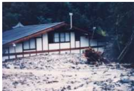
保全対象の被災状況
