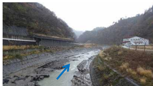
【現在の復旧状況】
