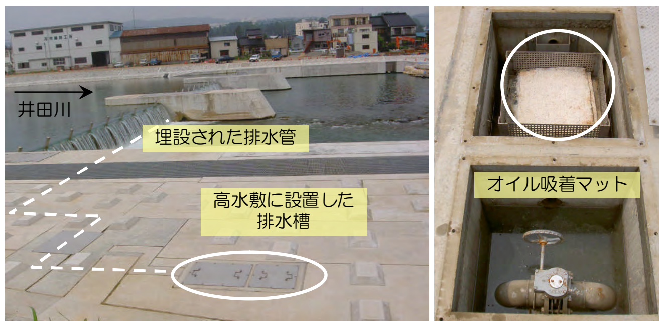
開閉装置等の油流出対策（堰柱内の排水を排水槽に集中処理）
