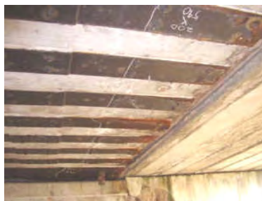
主桁のひび割れ・コンクリート補強材の損傷
