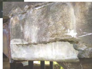
梁部の剥離・鉄筋露出
