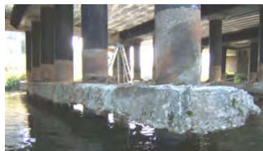
【中川橋の損傷状況】
