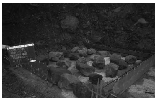
粗石混入状況
