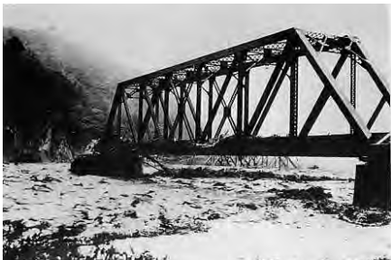
橋脚の流失(能美電鉄)
