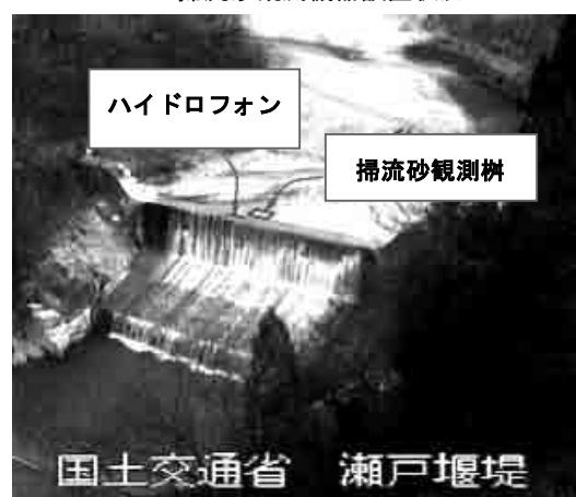
掃流砂観測機器設置状況
