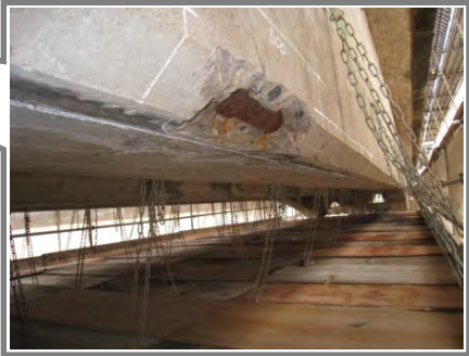
平成22年度補修前の状況
