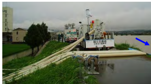
川田川樋管で稼働する排水ポンプ車
