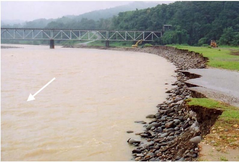
梅雨前線豪雨による洪水で、低水護岸が整備されていない箇所では、河岸浸食が進行した。
